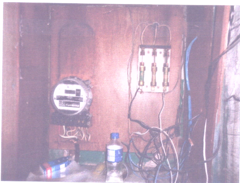
Figura 76 - Quadro de luz.
