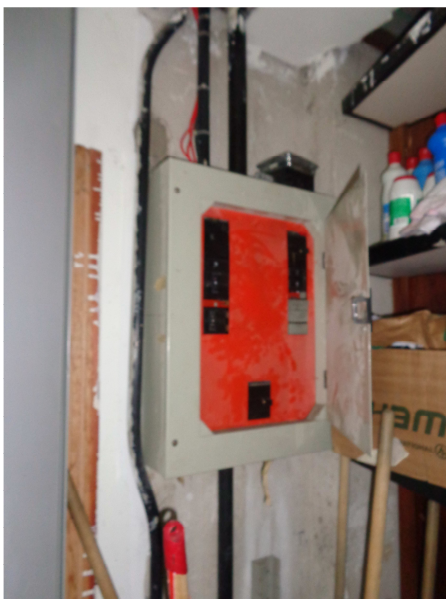
QUADRO DE DISTRIBUIÇÃO DE LUZ E TOMADAS 1
