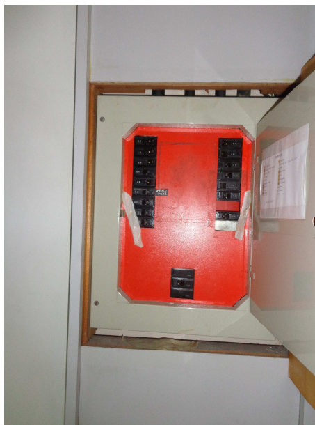
QUADRO DE DISTRIBUIÇÃO DE LUZ E TOMADAS 2
