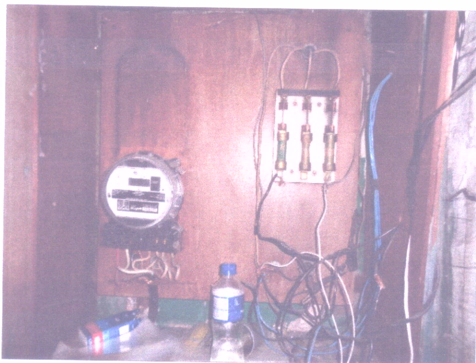
Figura 76 - Quadro de luz.
